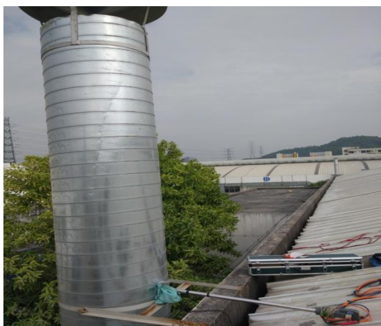
1#有组织废气处理后排放口
