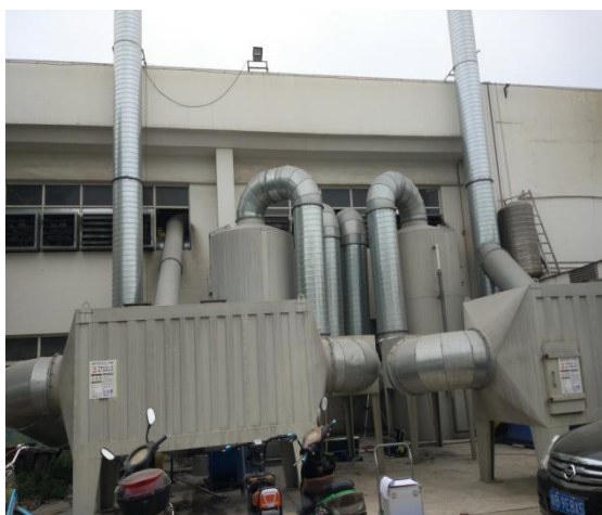
废气处理设施
